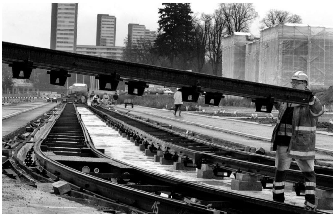
18 Meter lang und drei Tonnen schwer: Ein Fertigelement für den Gleisbau trifft auf der Baustelle ein.
