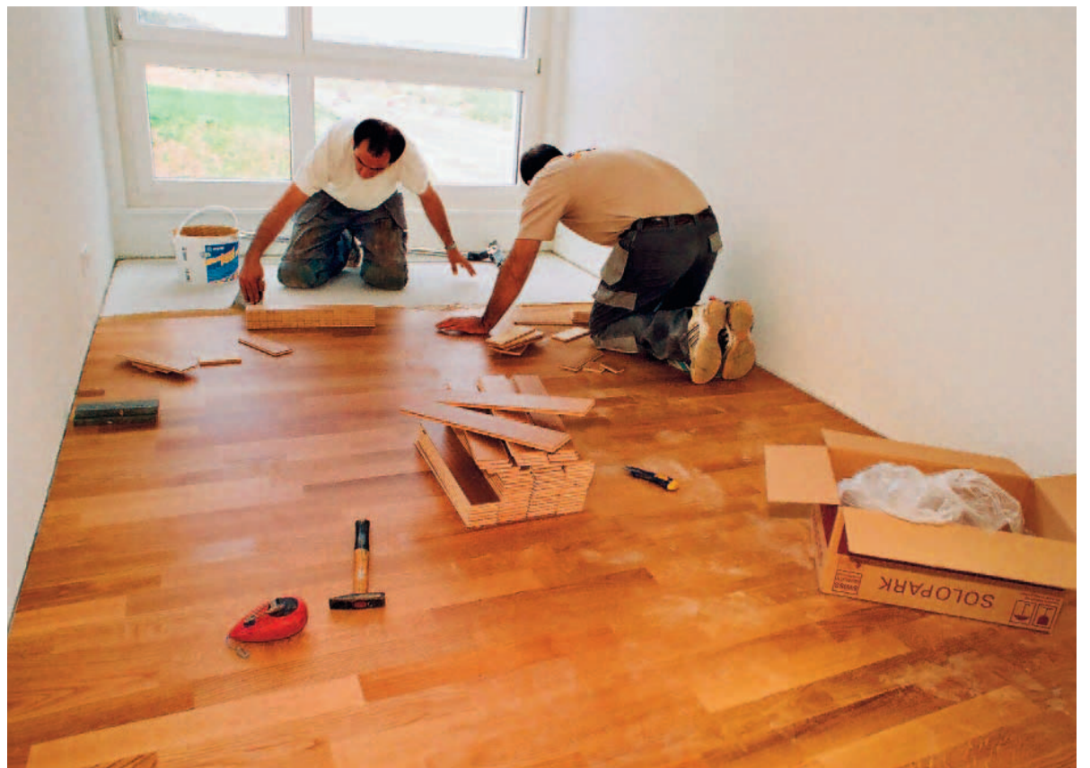
Die Parkettböden sind verlegt: Am 1. Juli ziehen die ersten Bewohnerinnen und Bewohner ins neue Stadtquartier Brünnen ein.
