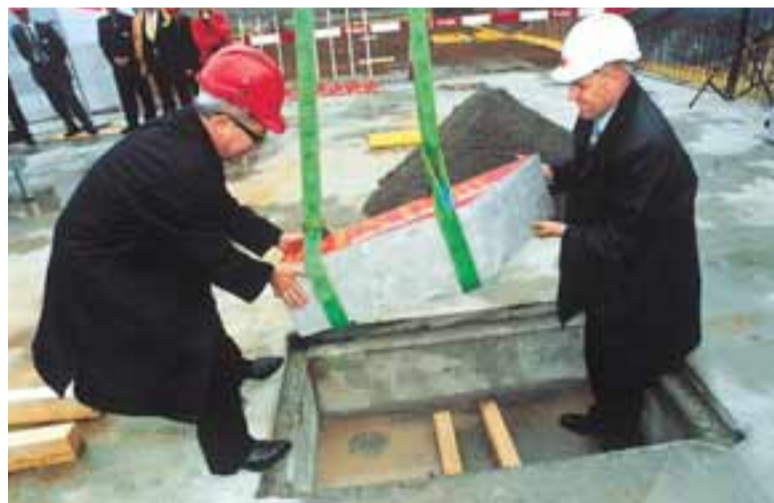
Grosser Moment für WESTside und die Stadt Bern: Architekt Daniel Libeskind und Anton Gäumann, CEO Neue Brünnen AG und Gesamtprojektleiter WESTside, legen gemeinsam den Grundstein.
